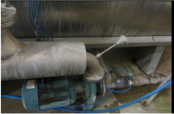
Zdjęcie 4. Pompa obiegu wody [źródło własne]
